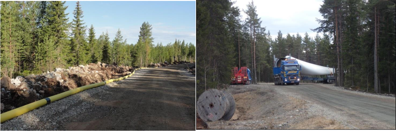
Kuva 5.6. (Vasemmalla) Esimerkki tuulivoimapuiston rakennus- ja huoltotiestä. Teitä käytetään muun muassa betonin, soran ja voimaloiden komponenttien kuljetuksiin sekä tuulivoimapuiston käyttövaiheessa huoltoajoihin. Maakaapeli sijoitetaan ojakaivantoon tien reuna-alueelle. (Oikealla) Tuulivoimalan osia kuljetetaan erikoiskuljetuksina. (Kuvat: Ville Suorsa / FCG).
