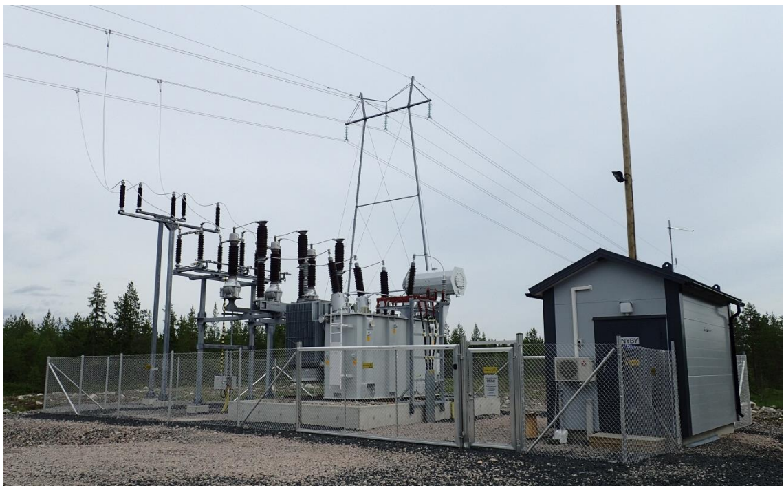
Kuva 5.7. Esimerkki tuulivoimapuiston sähköasemasta (kuva Minna Takalo/FCG).
